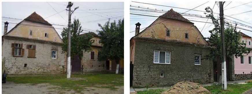
Figura 3: nr.156, Laslea sat. 2003 (l) și 2009. În 2003, proprietatea prezenta avarii sub forma de crapaturi și daune cauzate de apă care amenință stabilitatea structurală, până în 2009, acest prejudiciu nu a fost abordat, dar au fost instalate ferestre PVC . (Autor)
